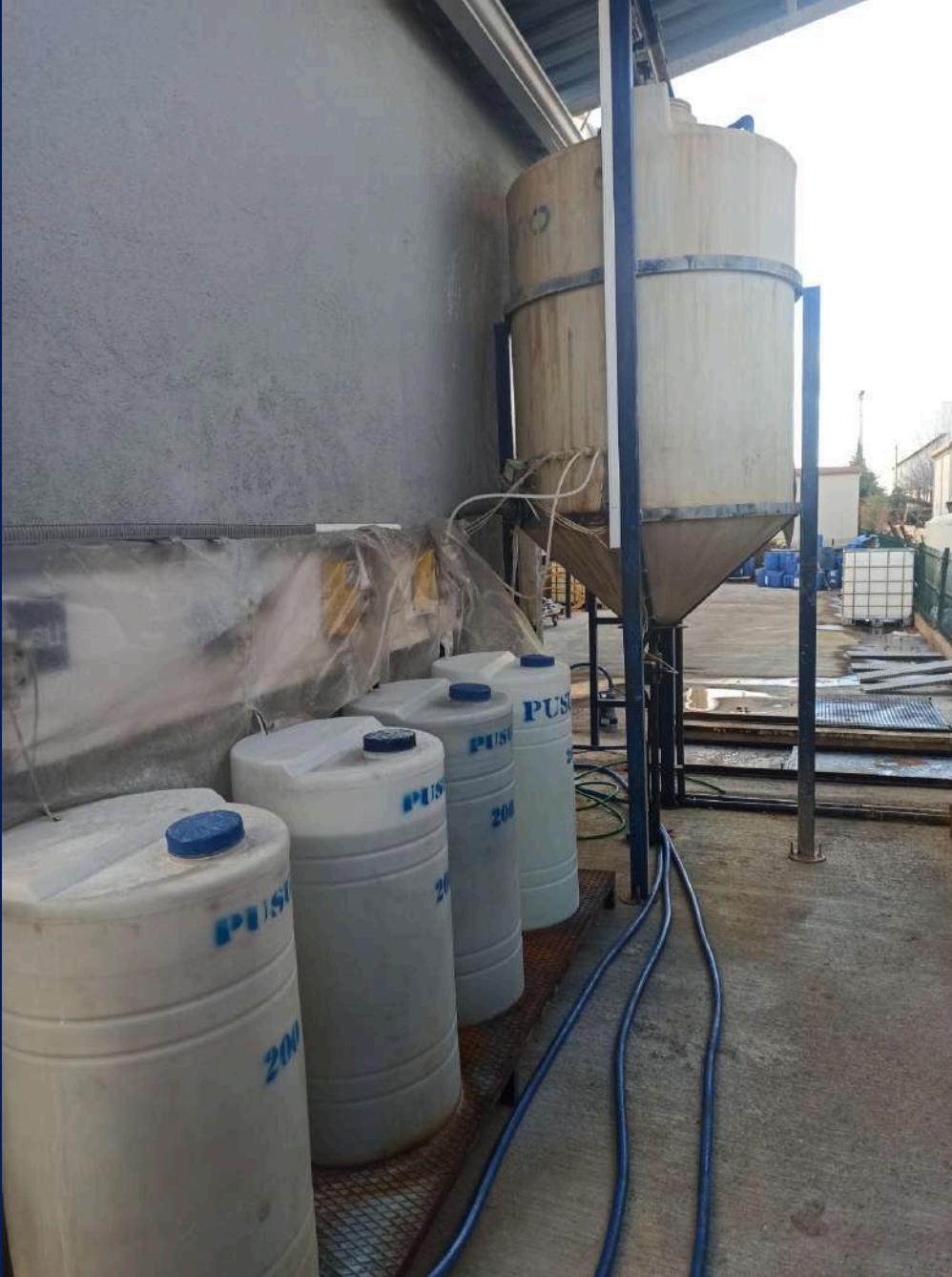
Dozaj tankları ve hazırlama ünitesi / dosing tanks and make-up unit
