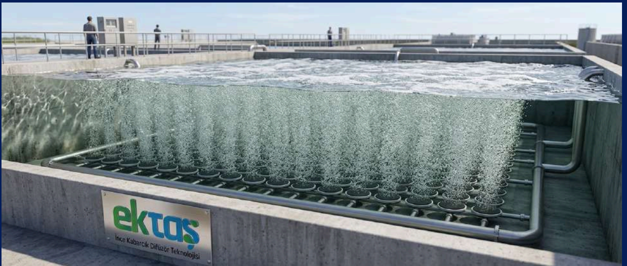
İnce kabarcıklı difüzörlü havalandırma havuzu — membran disk difüzör ızgarası / fine-bubble diffused aeration basin, membrane disc diffuser grid
