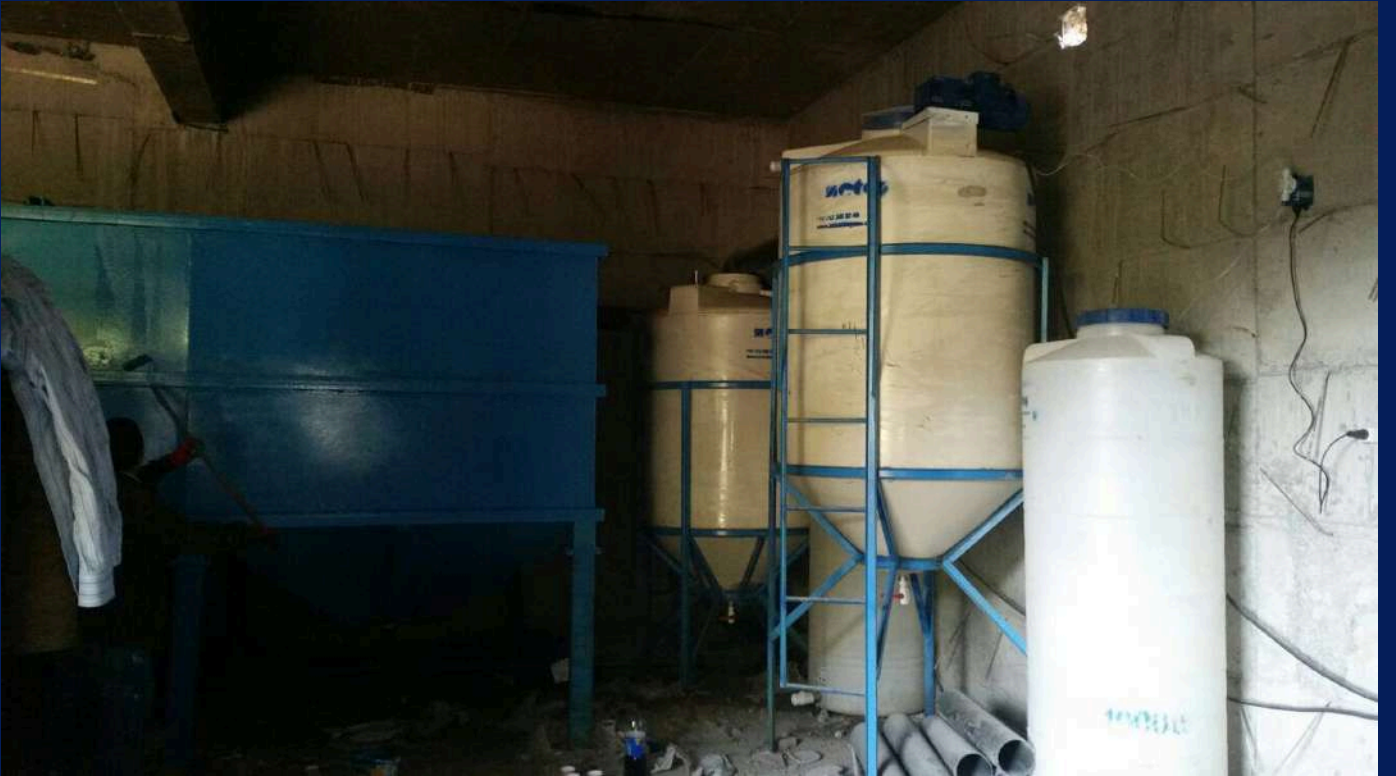
Kimyasal arıtma ünitesi — hazırlama tankı ve dozaj hattı, sahada / chemical treatment unit, make-up tank and dosing line on site
