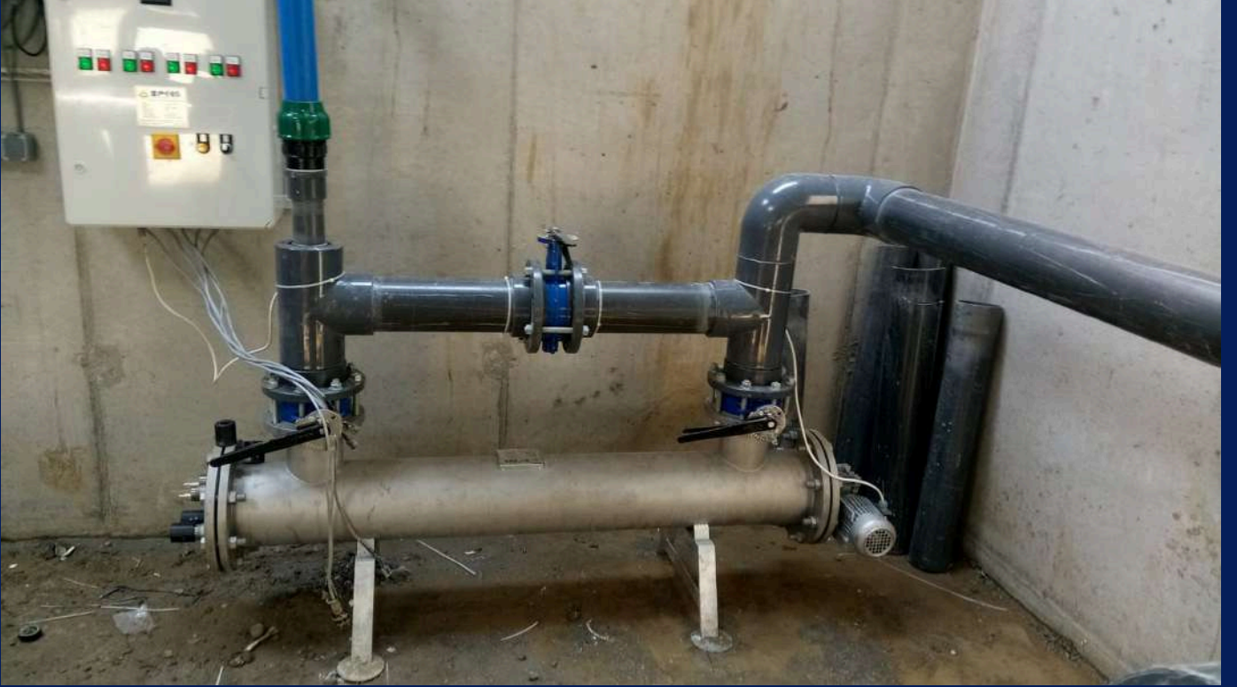
Otomatik yıkamalı UV dezenfeksiyon ünitesi — paslanmaz reaktör ve kontrol panosu, sahada / self-cleaning UV disinfection unit, stainless reactor and control panel, on site
