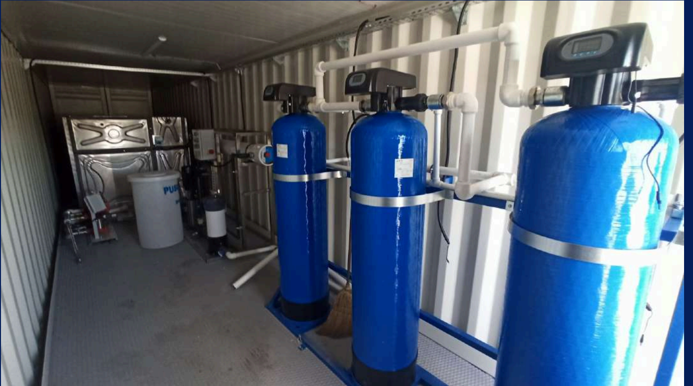
Konteyner içine kurulmuş arıtma ünitesi / treatment unit installed in a container
