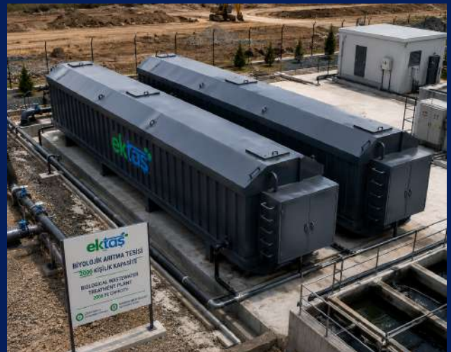
2000 kişilik paket biyolojik atıksu arıtma tesisi — çift hat çelik reaktör, sahada / 2000 PE packaged biological treatment plant, twin steel reactors on site
