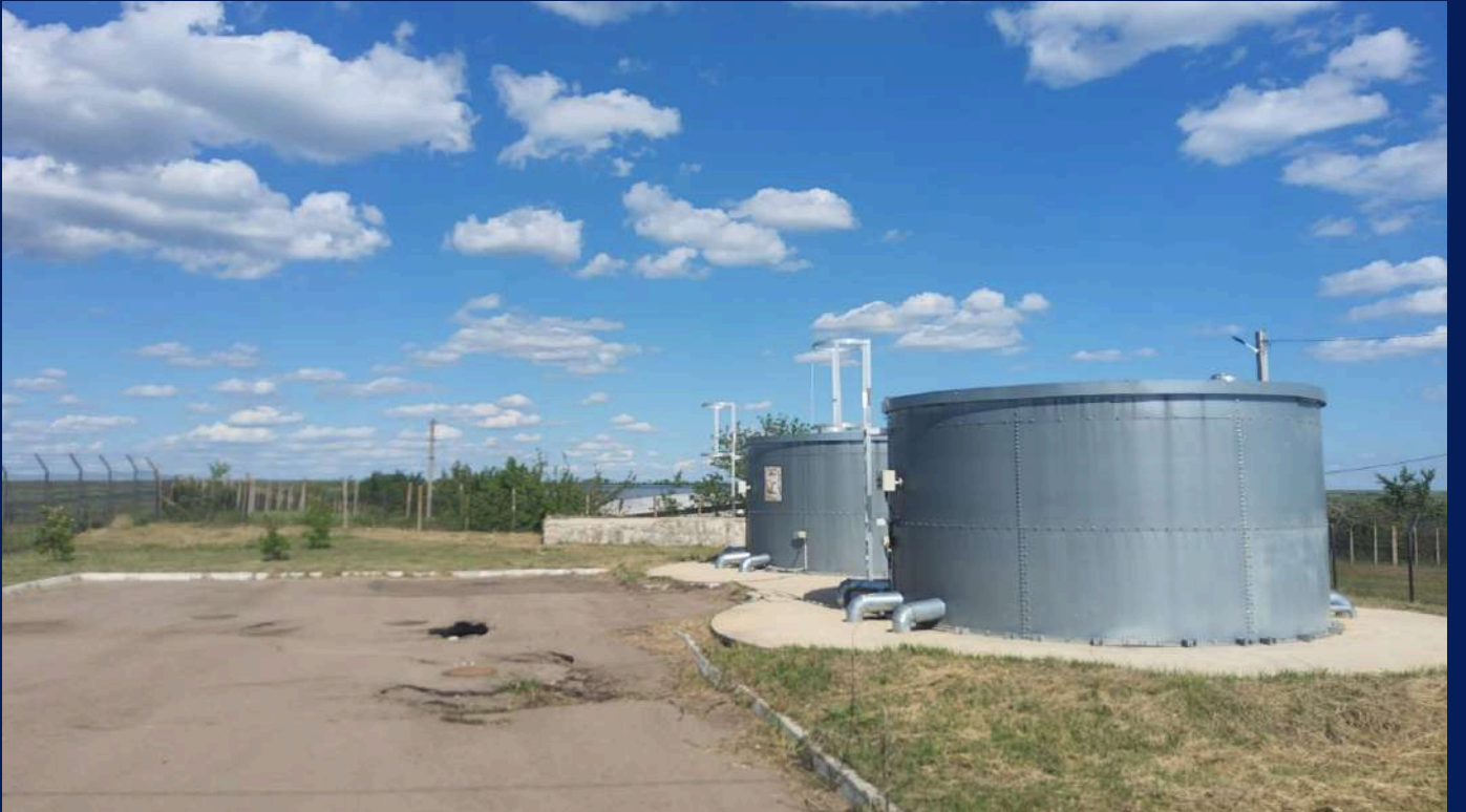
Arıtılmış su deposu, tesis sahası / treated water tank on site
