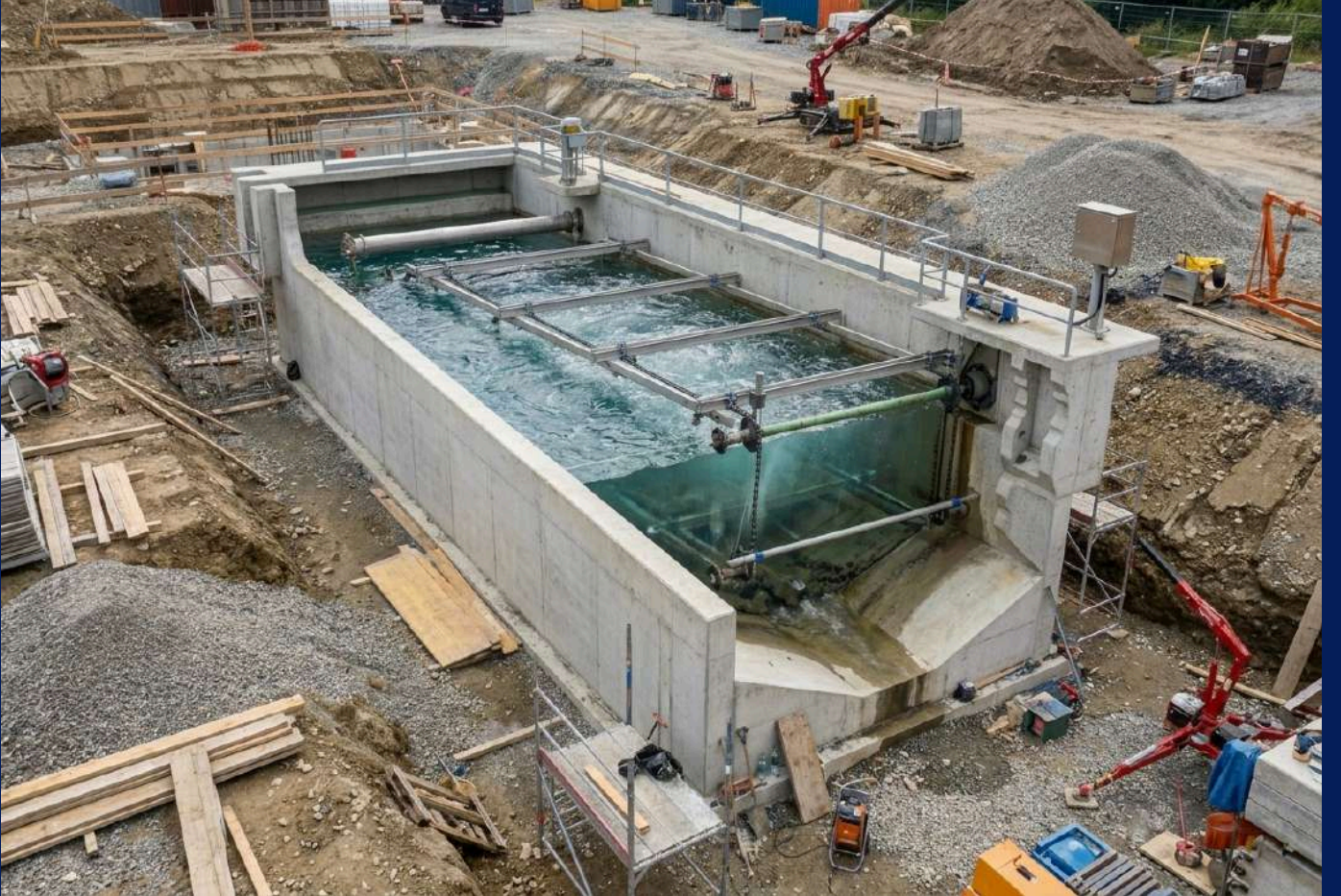
Dikdörtgen çöktürme havuzları — zincirli sıyrıcı ve savak, sahada / rectangular clarifiers with chain-and-flight scrapers and weirs, on site
