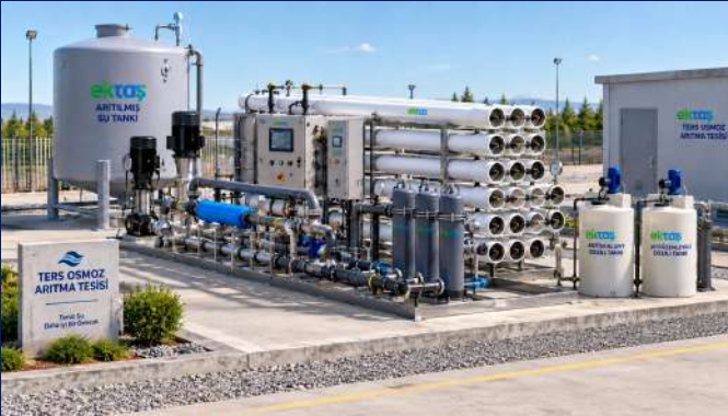
RO hattı — saha kurulumu / RO train, site installation
