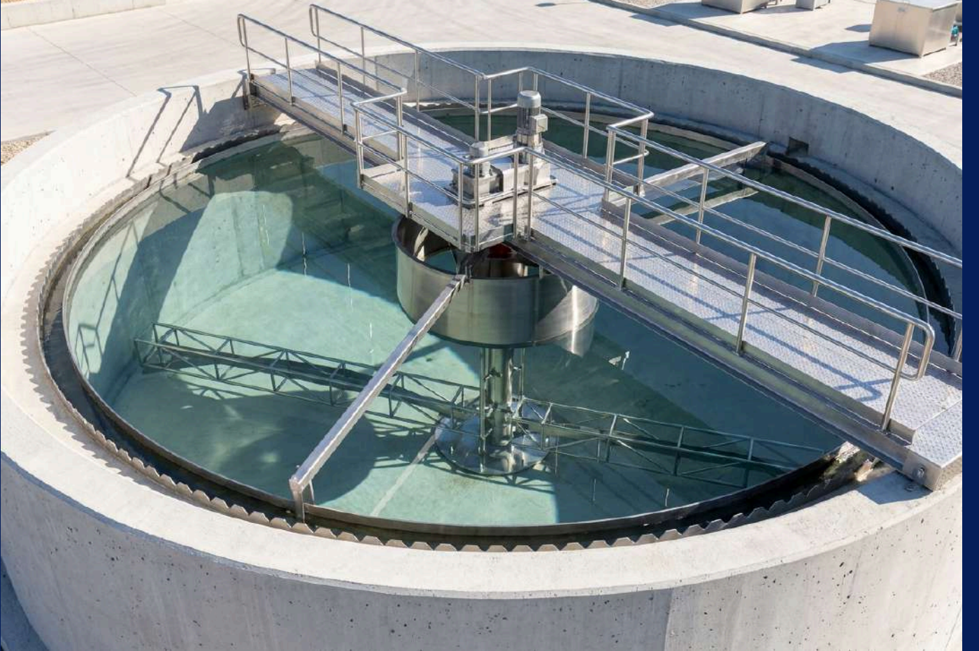
Dairesel çöktürme havuzu — döner köprü ve savak / circular clarifier, rotating bridge and weir
