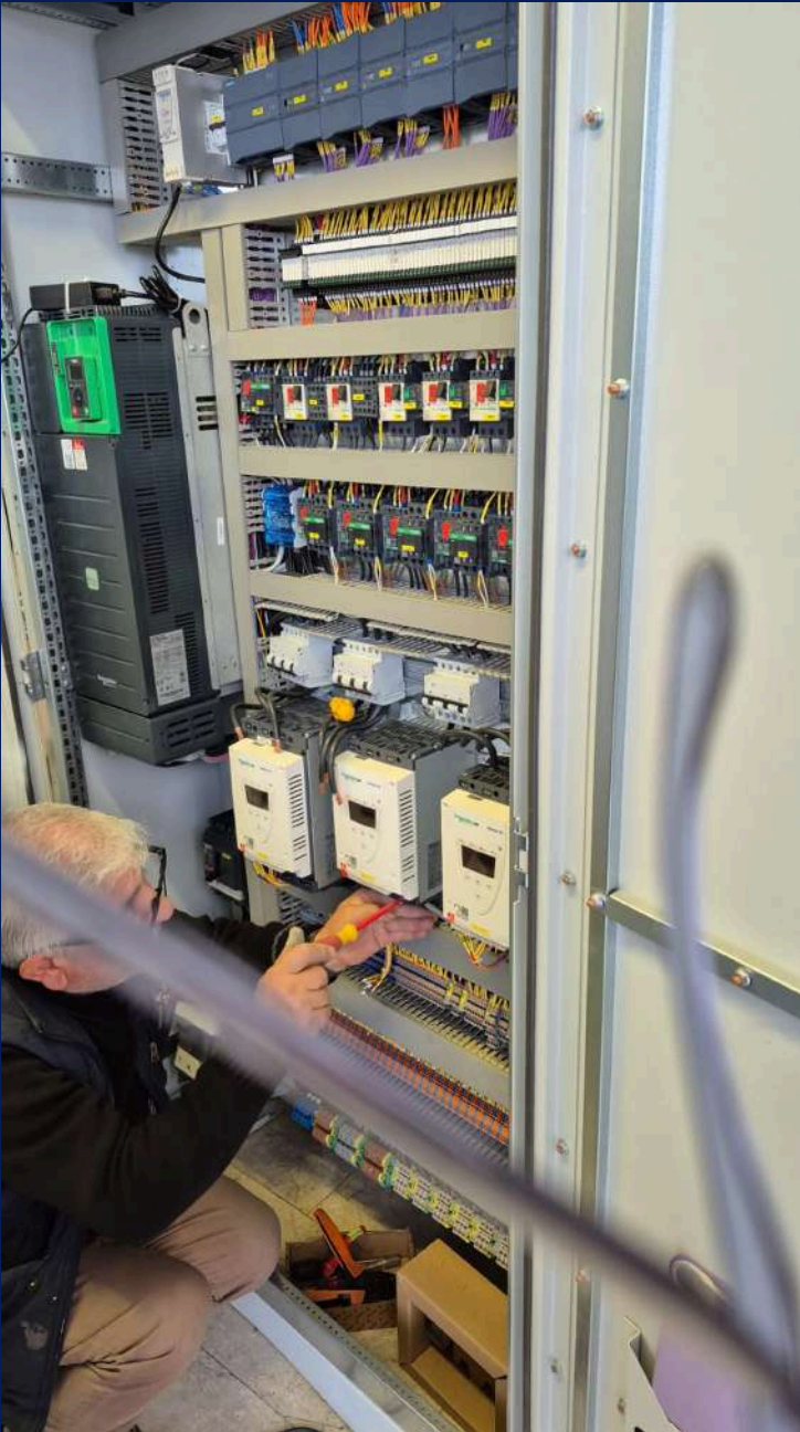
MCC panosu, kendi imalatımız / MCC panel, our own build
