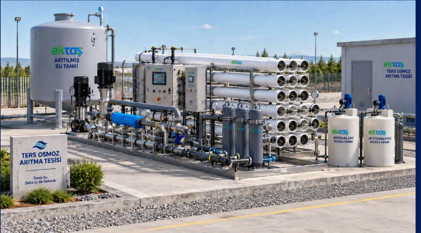
RO tesisi — ön arıtma, skid ve ürün suyu deposu / RO plant: pretreatment, skid and permeate tank
