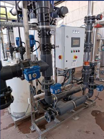
Ünite üstü kontrol panosu ve enstrümanlar / unit-mounted control panel
